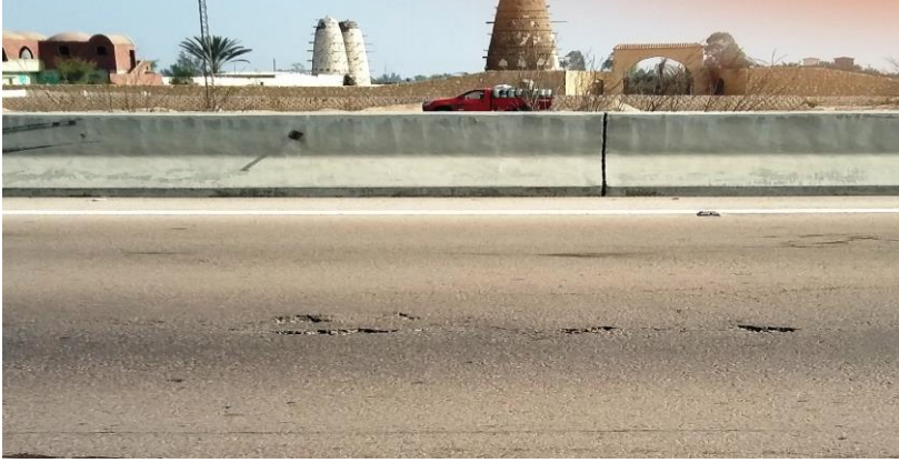
صورة (٢) انتشار الشقوق بالقطاعات التي لا توجد بها خنادق لتصريف مياه الأمطار على طريق القاهرة / الإسكندرية الصحراوي ، بتاريخ ٢٠٢٠/٨/١٤ م ، " ناظرًا صوب الجنوب الشرقي".
